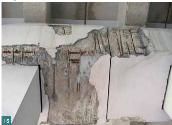
Obr. 16 Korozí výtzuže staviva mostu v důsledku chybného návrhu opravy (zvýšení vlhkosti betonu po aplikaci systému s maltami a povlaky se sníženou paropropustností, ponechání chloridů v betonu v kritické koncentraci, chybná dodávka mostního závěru s výsledným zatékáním do sanované konstrukce z vozovky) ■ Fig. 16 Corrosion of the reinforcement of the bridge as a result of an incorrectly designed repair (increased wetness of concrete after applying a system with mortars and covers with low steam permeability, leaving chlorides in concrete in critical concentration, wrong supply of expansion joint with resulting leakage into the repaired structure from the road surface
